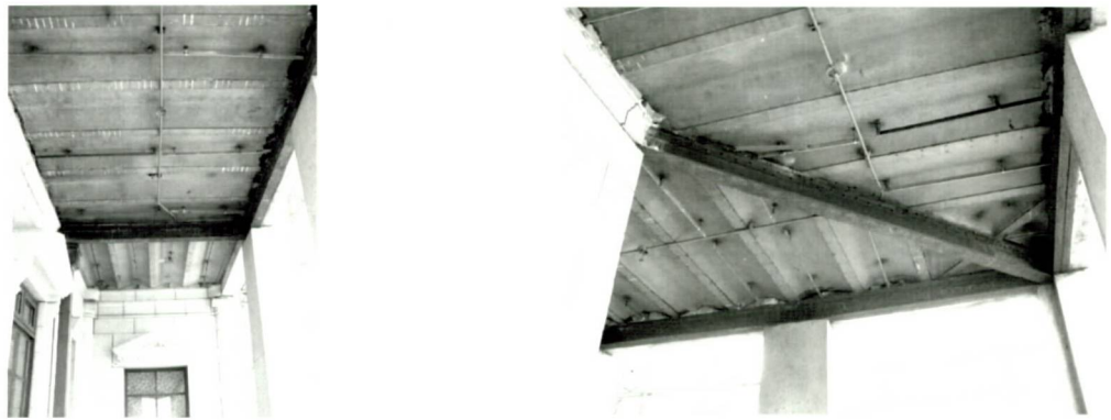
사진 1-23,24. 2007년 수리과정에서의 2층 천장부분(화살표참조)
