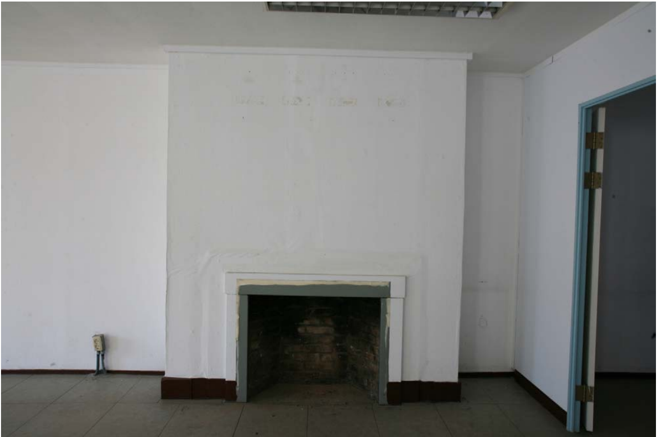
중명전 2층 남쪽방 벽난로(보수 전)
