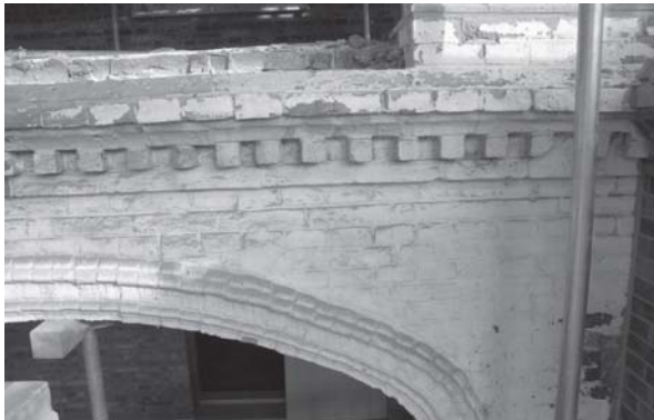
[사진 4-66] 세척 전 외벽 도장상태
