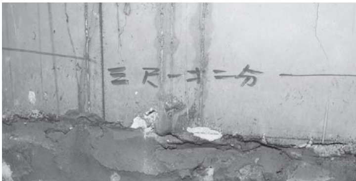
[사진 3-212] 2층 벽난로에 새겨진 문구
